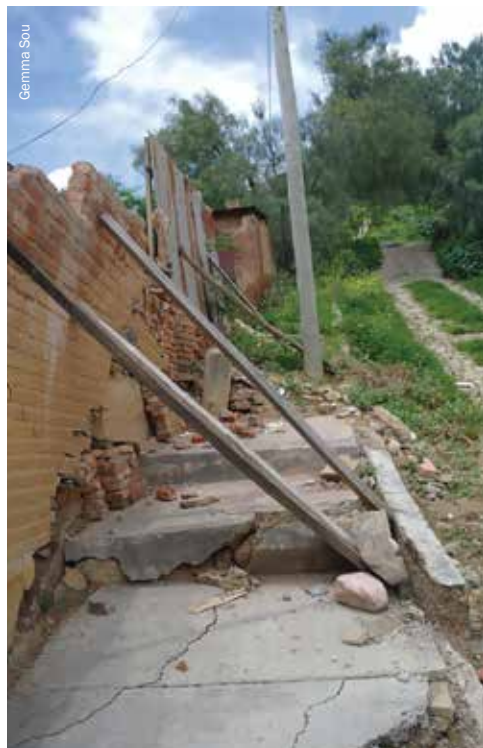
Paredes apuntaladas tras el desprendimiento de tierra, en Cochabamba.
